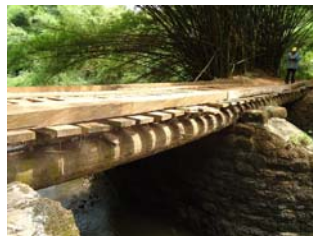
Pont Mazi sur la route de Dulia
