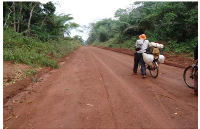
Etat de la route à 7 Km de Buta
